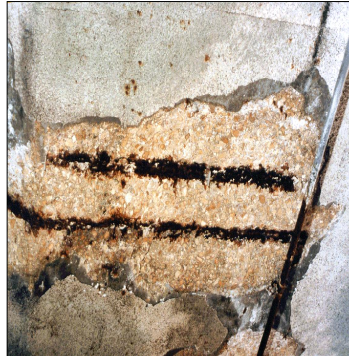
Presença de cloretos
