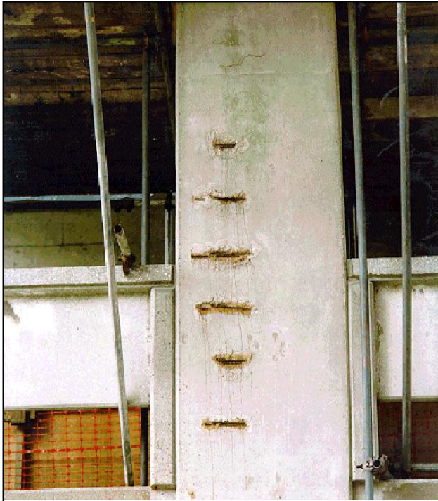
Carbonatação / Recobrimento insuficiente
